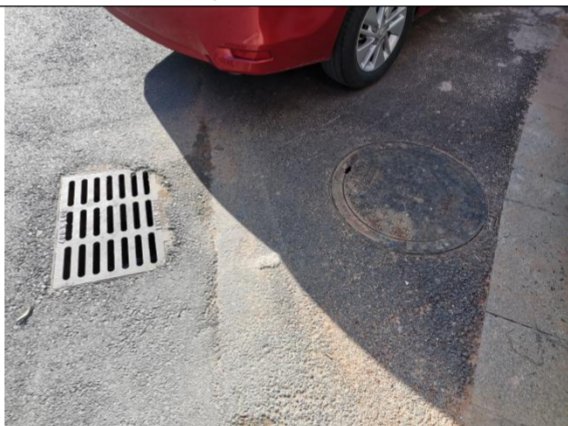
雨水井、雨水口
